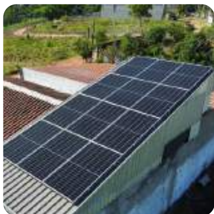
Projeto Residencial 6,54kWp - 12 Módulos Serra - ES
