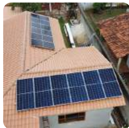
Projeto Residencial 6,48kWp - 12 Módulos Guarapari- ES
