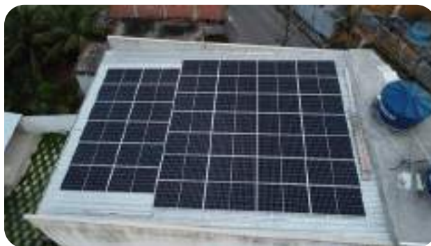
Projeto Residencial 15,00kWp - 40 Módulos Serra - ES
