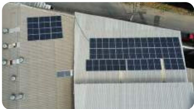
Projeto Industrial 27,00 kWp - 54 Módulos Cariacica - ES
