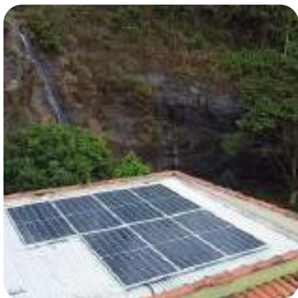
Projeto Residencial 3,15kWp - 07 Módulos Guaçuí - ES
