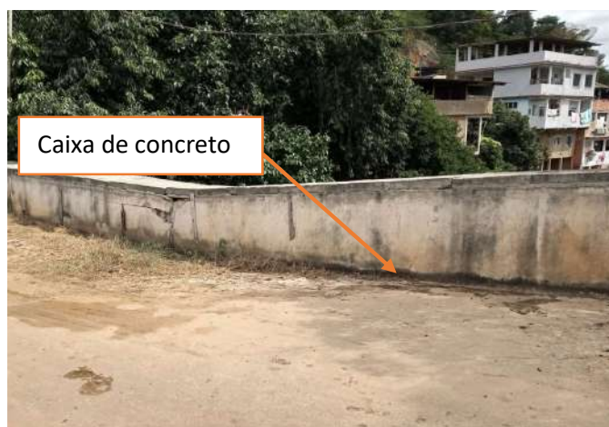
Figura 5 - Imagem da caixa de concreto para tubulação
